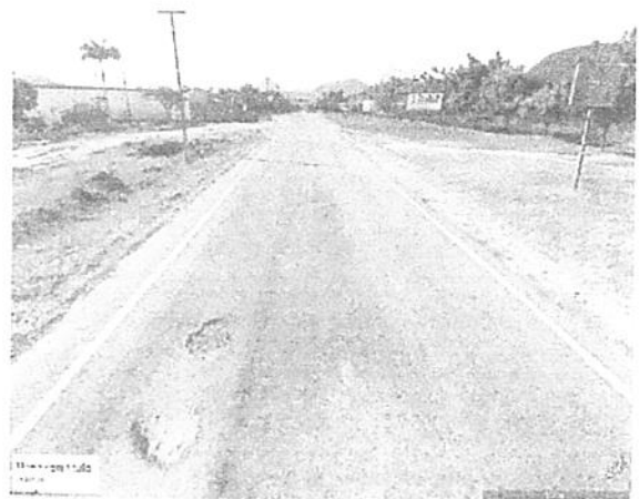
Foto 02 – presença de buracos na pista
