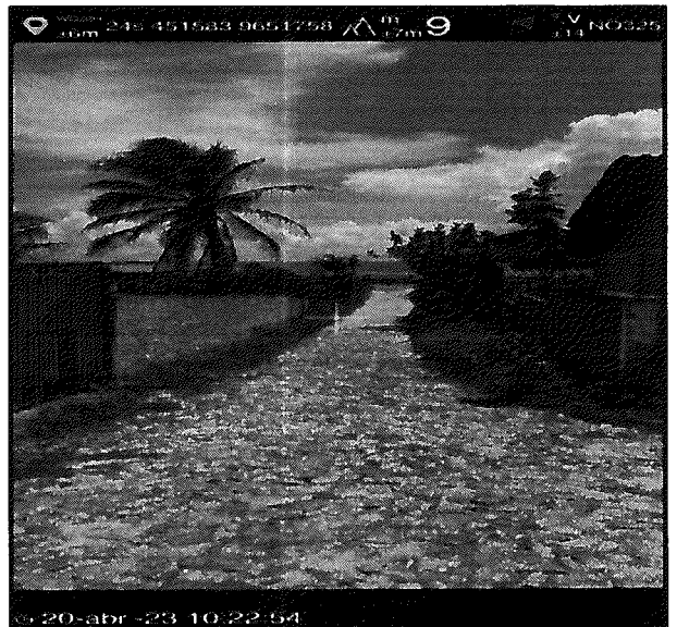
Foto – Presença de remendos na pista.
