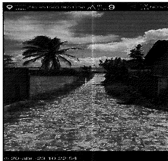
Foto – Presença de remendos na pista.
