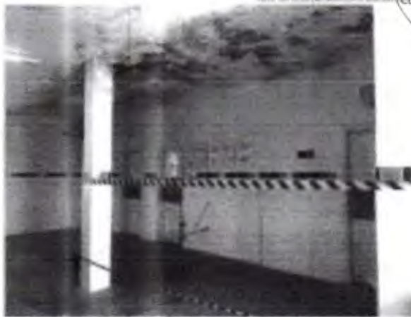
O posto Anacleto Magalhães tem problemas de rachaduras, infiltrações e falta reconstrução de materiais
